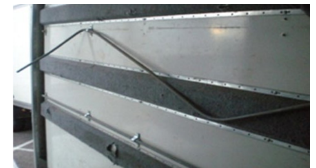
↻ Polsterung und Stangen: Stangen, Befestigungen, Polster fehlen oder sind verformt, können nicht auf wirtschaftliche Weise repariert werden
