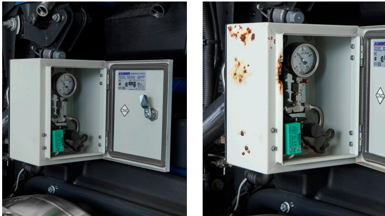
Rost auf Einfüllstutzen-Schutzkasten → Vermerk über den Schaden, ohne Berechnung.
