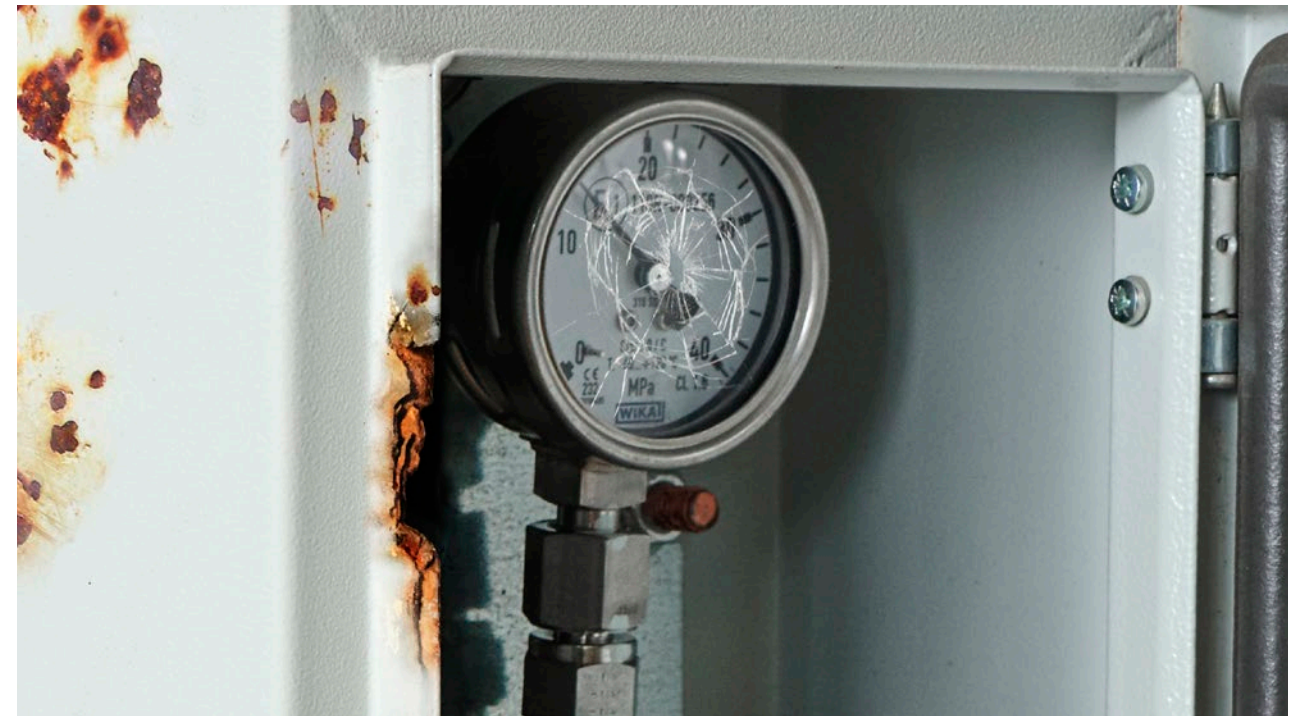
Fehlender Schutzkastenschlüssel, CNG-Stutzen oder Druckmesser beschädigt → Berechnung des Austauschs des gesamten Kastens.
